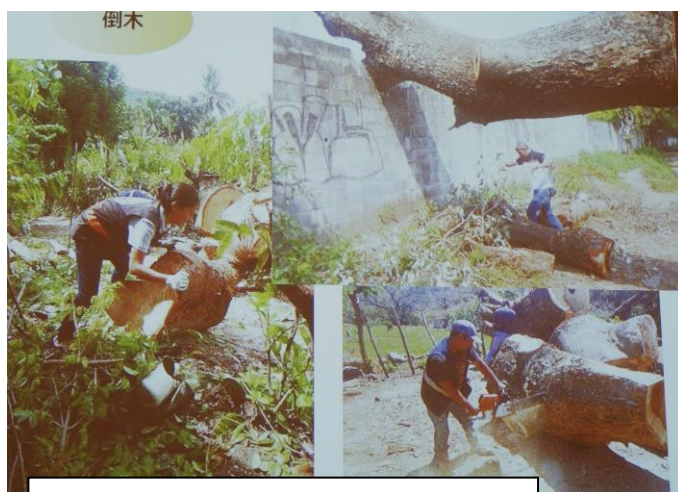
倒れた大木の処理も少なくなかった
